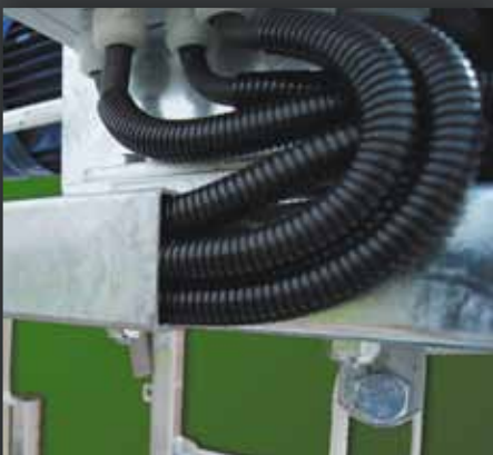
Alle elektriciteitskabels zijn voorzien van bescherming, en netjes weggewerkt.
